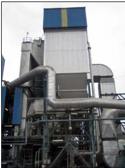
Incineradora da planta de Sogama
